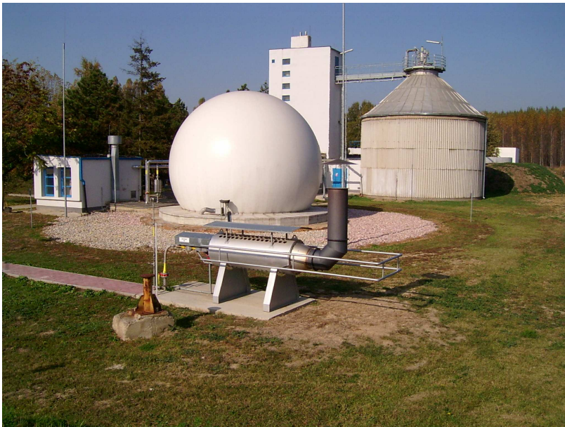
Obr. 5-2 Celkový pohľad na zásobník bioplynu a horák prebytočného bioplynu na ČOV KOMVaK
