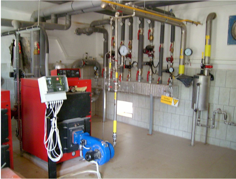
Obr. 5-1 Pohľad do kotelne ČOV spoločnosti KOMVaK
